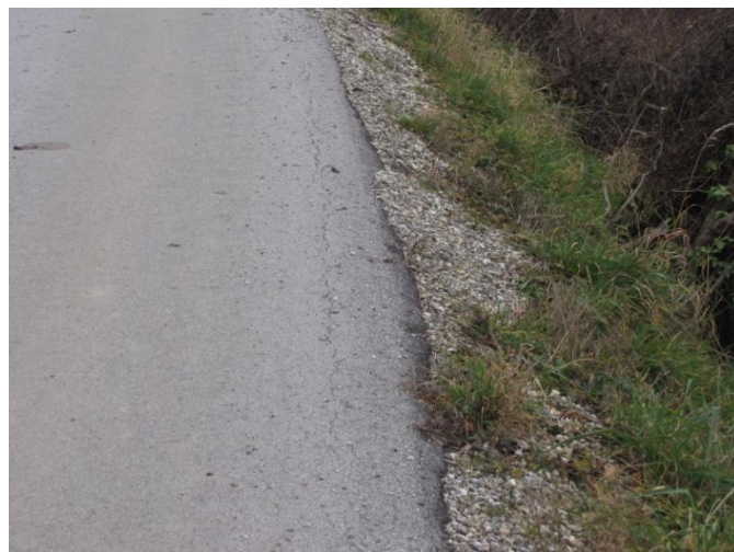
Na sliki vidne nove razpoke na asfaltu
